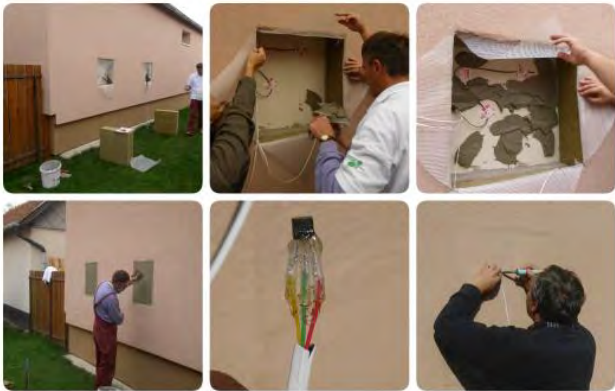
Homlokzati fal és hőszigetelés monitoringrendszere
